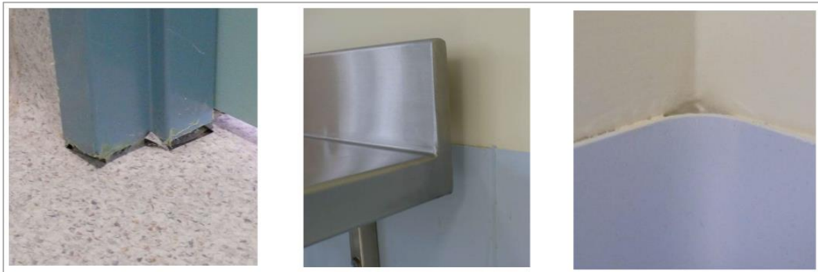
2. ábra Nem elfogadható hézagok, rések épületen belül
